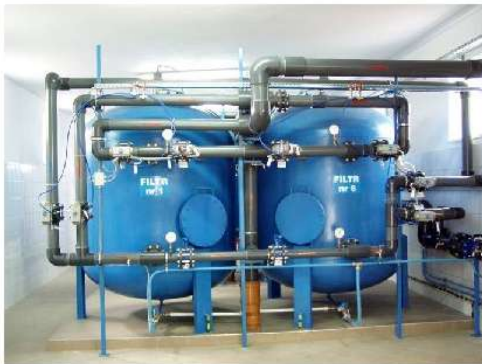
Stacja uzdatniania wody w SARBII
