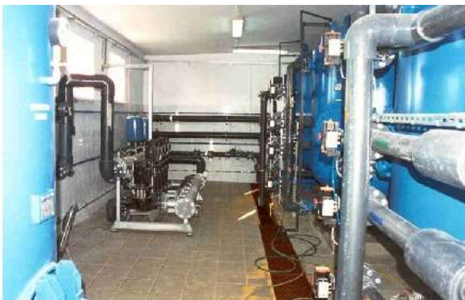
Stacja uzdatniania wody w Dusznikach.
